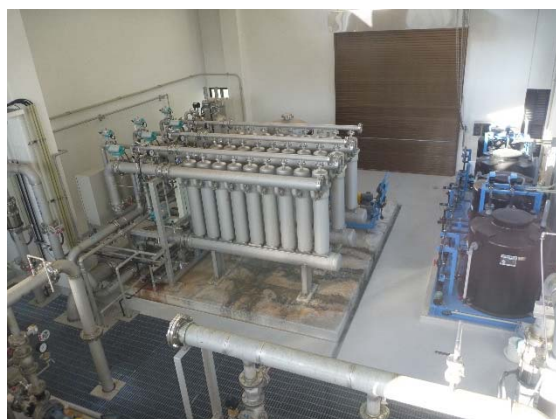
「桜江浄水場・膜ろ過設備」
