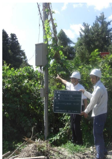
電柱番号：ED77NE2（田津）
