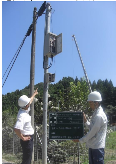
電柱番号：CU55NW1（川平）
