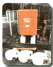
整備された消火設備
