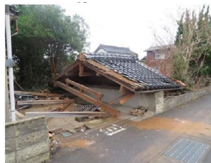
▲鳥取中部地震による住宅の倒壊
