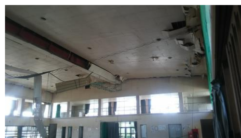
▲地震による天井落下
