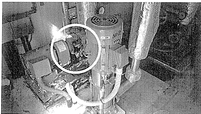
(送水ポンプ故障箇所)
