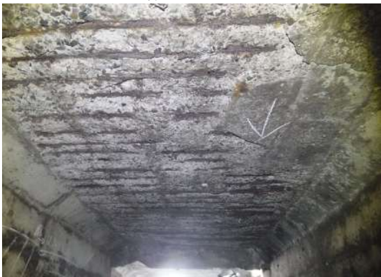
下水道管路特別重点調査業務（損傷状況） 2号都市下水路
