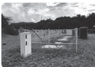
菰沢公園浄化槽
