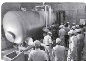
市民プール循環ろ過ポンプ
