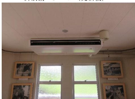
御前湯エアコン（更新後）
