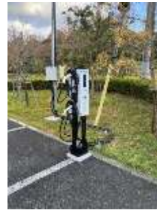
図7. EV 充電器_中央公園
