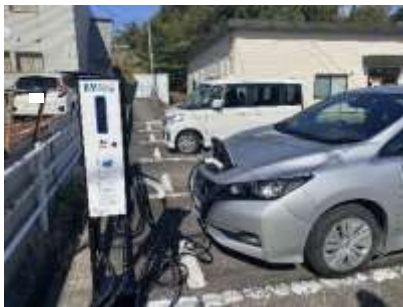
図6. EV 充電器_市役所分庁舎
