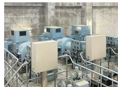
▲取水塔内部のポンプ3台の様子 点検時以外は無人です【写真4】
