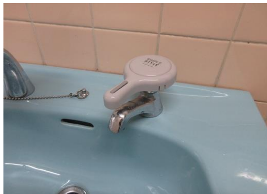
トイレ及び事務所内手洗い自動水栓化
