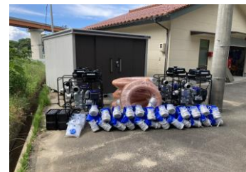
緊急排水エンジンポンプ 及び格納庫
