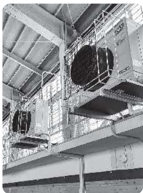
川本小学校体育館のエアコン
