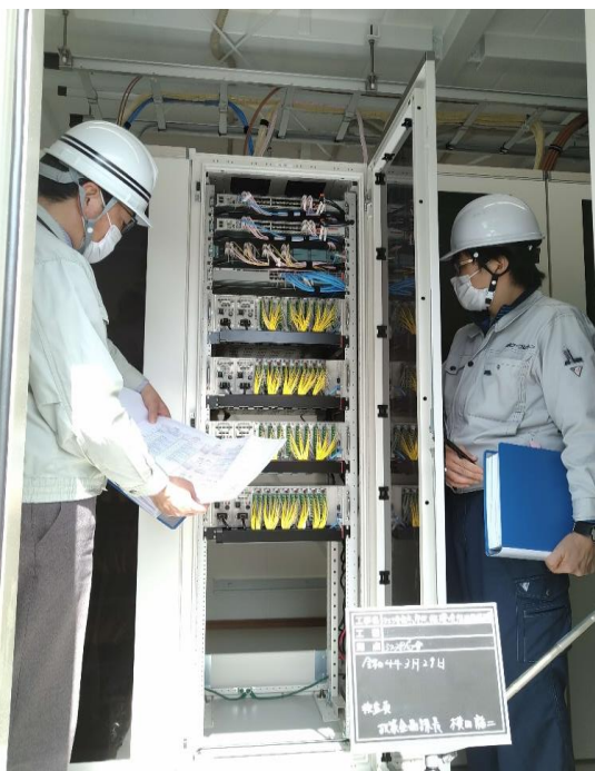
新・江津局舎内部装置
