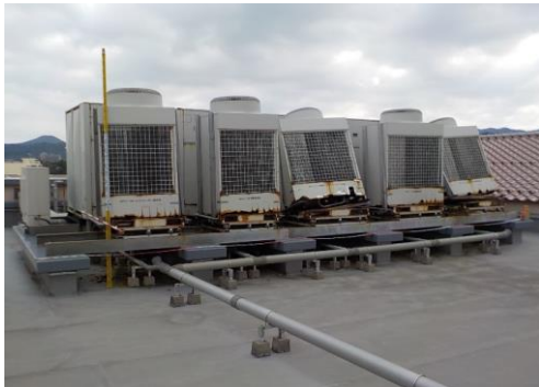
(倒壊した室外機)
