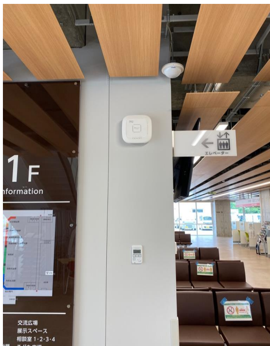
新庁舎1階に設置されたWi-Fi機器
