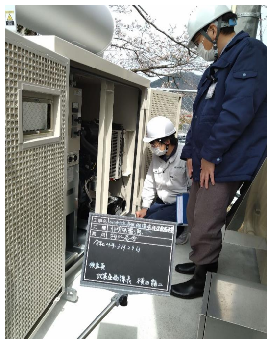
新・桜江局舎非常用電源
