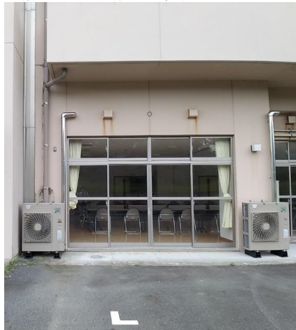
(個別型室外機の設置)
