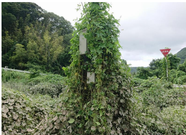
大雨で水没したCATV設備（桜江町田津）
