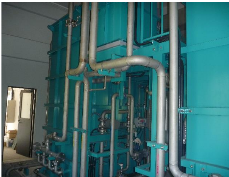
川越浄水場・膜ろ過設備
