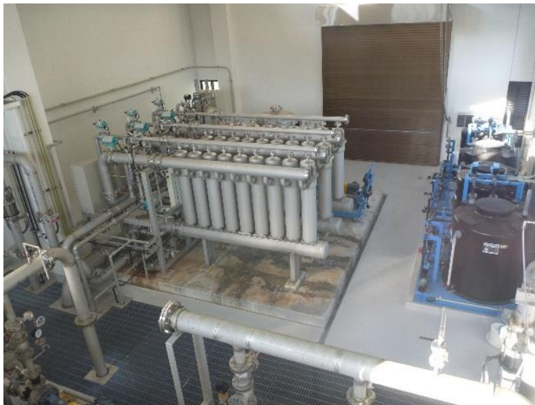
桜江浄水場・膜ろ過設備
