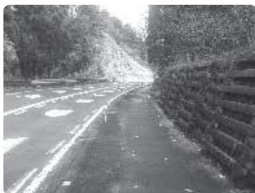
防護柵のない通学路(黒松町)
