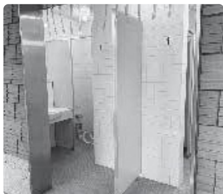
洋式化や改修整備が求められるトイレ
