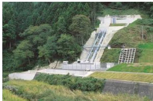
勝地発電所(水力発電)
