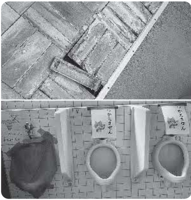
老朽化が進む施設
