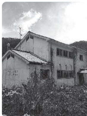
解体が急がれる廃校舎
