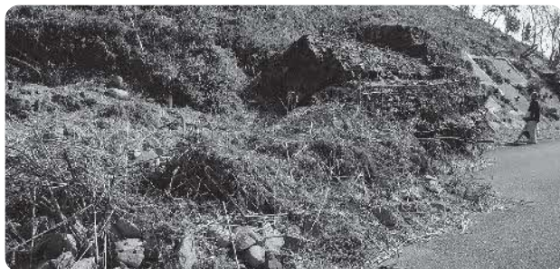
災害発生現場（波子）
