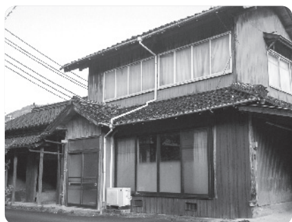
浸水後空き家となった家屋(桜江町小田)
